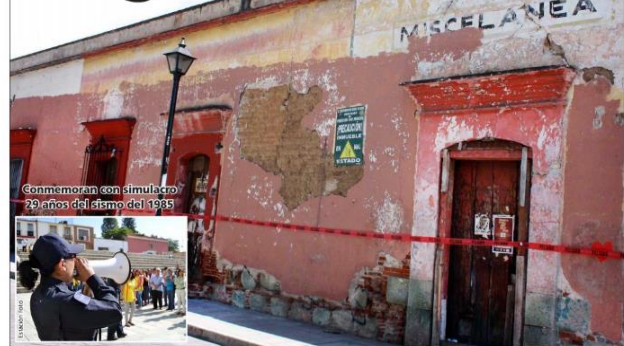
En el Atlas de Riesgo de Oaxaca realizado por geólogos de la UNAM, se detectaron 305 inmuebles considerados como riesgos dentro del polígono del Centro Histórico, 43 de ellos considerados altamente peligrosos ante la posibilidad de desplazarse al registrarse un sismo de 8 grados en escala de Richter. (Foto: archivo Carolina Jiménez)
